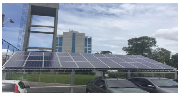
Figura 7- Gerador Fotovoltaico no Telhado do Bicicletário
