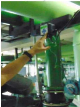
Figura 4- Condutivímetro para Água das Torres de Resfriamento.
