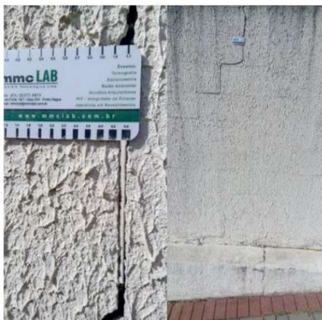
Foto 13 - Abertura da junta com 5mm no muro casa 376.
