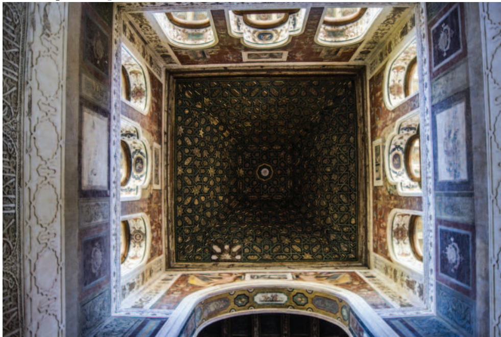
Figura 33. Aberturas superiores para extracción de aire cálido
