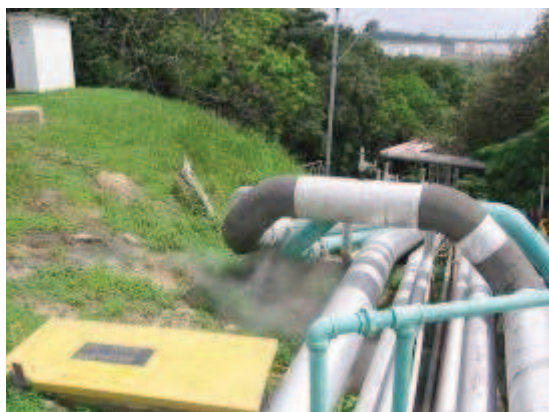
Desperdício de vapor
