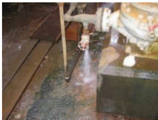
Sistema de drenagem ineficaz
